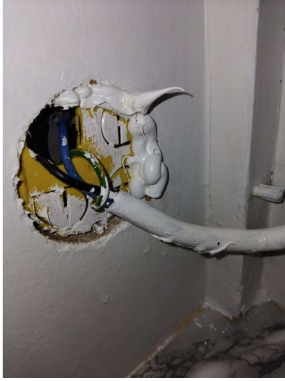
Enveloppe de protection absente ou détériorée - Espace 1.3 (Salle d'eau), Espace 0.6 (Chaufferie), Espace 2.1 (Garage)
